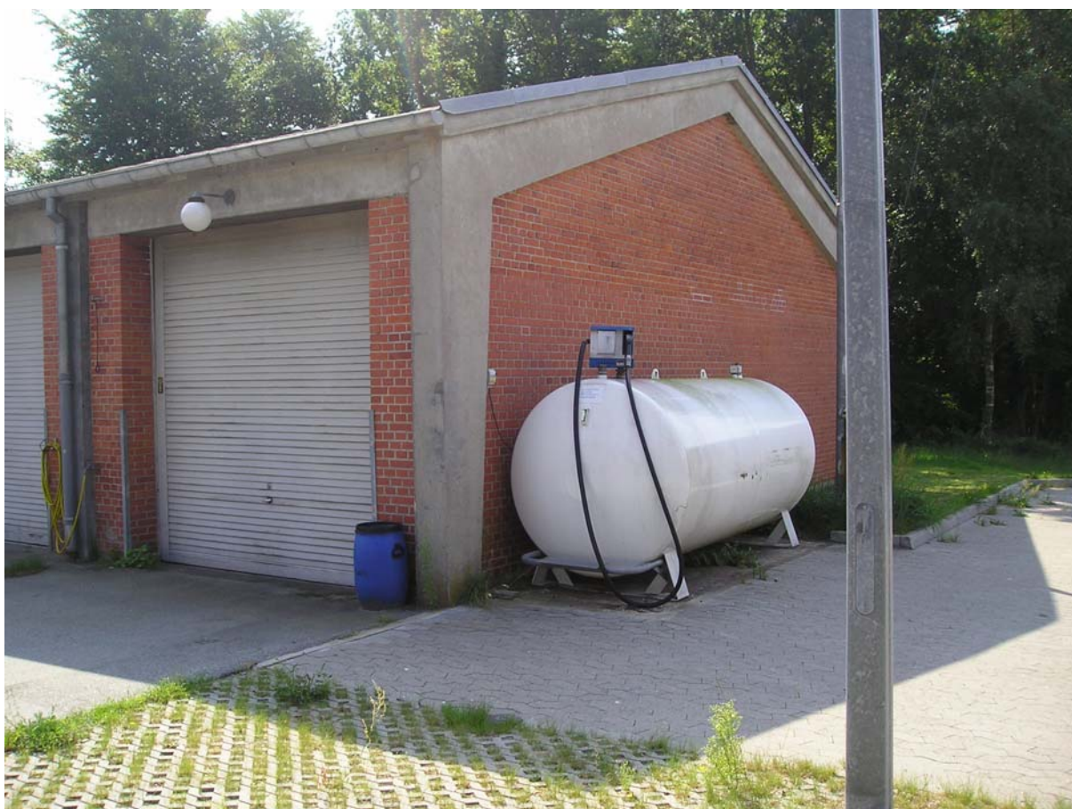
Foto 2: Bygning 3, overjordisk tank til dieselolie.
