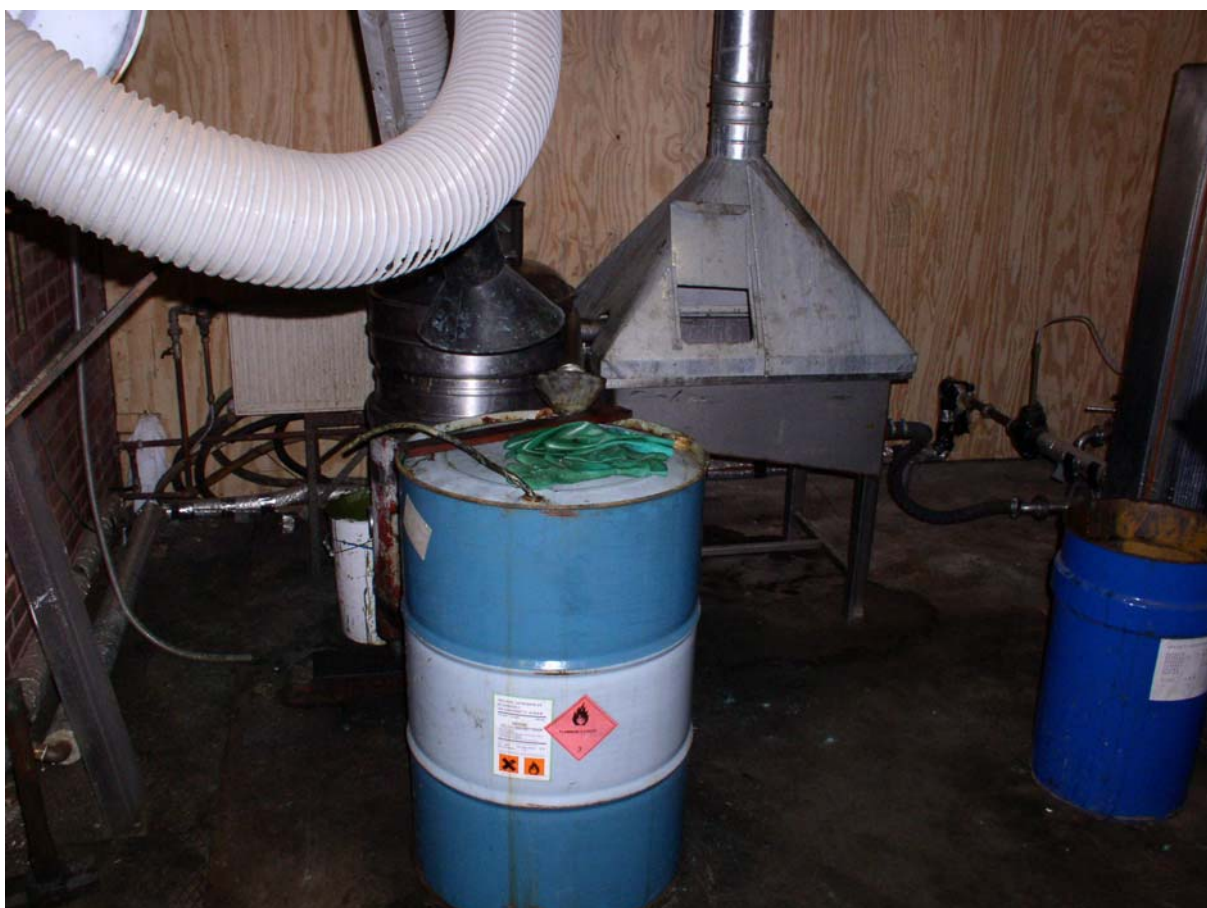
Foto 12: Bygning 11, oliecentrifugerum til olie- og fedtudsikling fra spildevand inden det ledes til forreenseanlæg.
