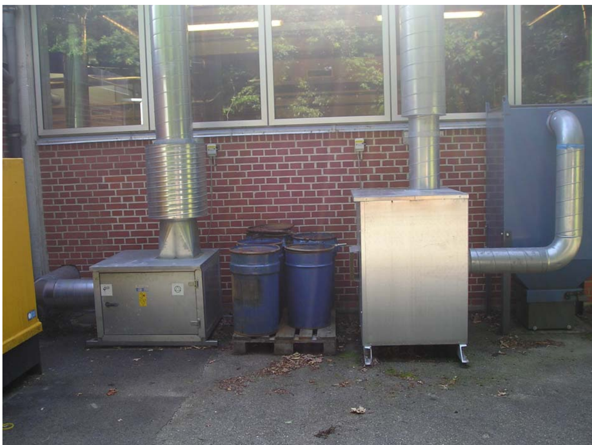
Foto 26: Bygning 32 (vestside), udendørs oplag af slibestøv fra bygningens udsugningsanlæg.
