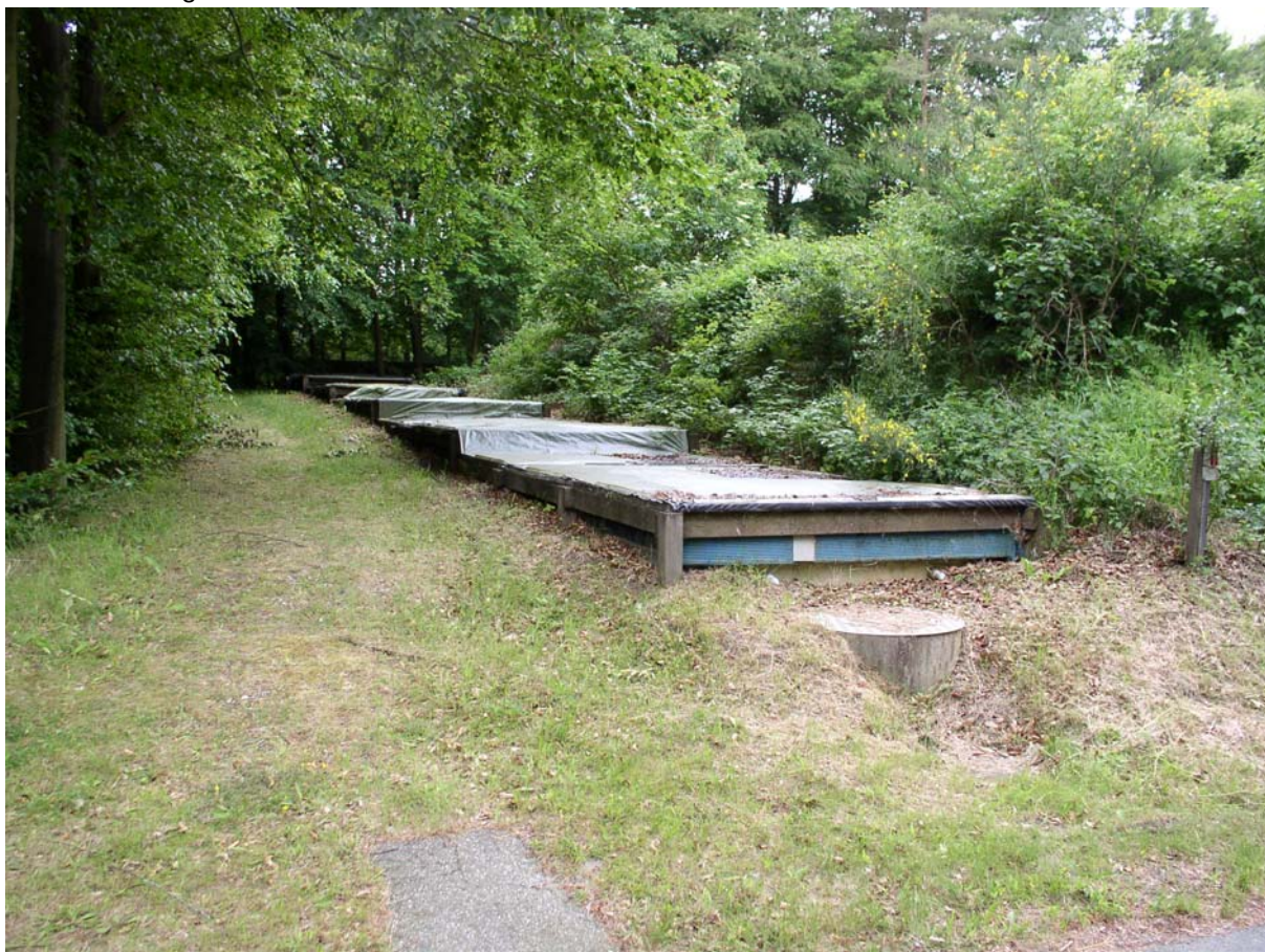
Foto 43: Bassiner til rensning af spildevand fra bygning 6 og 16.
