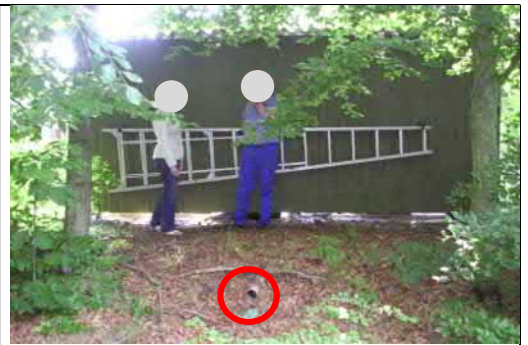
Foto 2: Bygning 19, skuret har afløb til ubefæstet areal bag skuret. Afløb fremhævet med rød cirkel.
