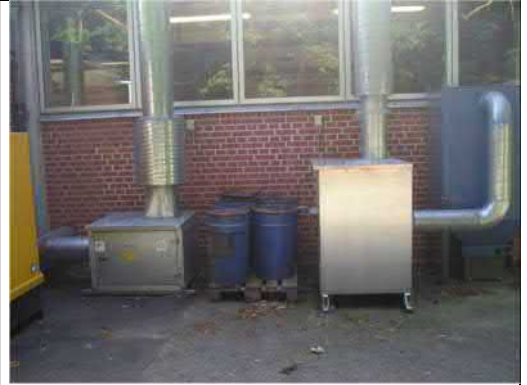
Foto 2: Bygning 32 (vestside), udendørs oplag af slibestøv fra bygningens udsugningsanlæg.
