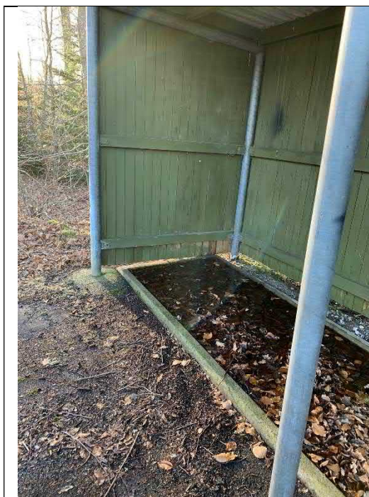
Foto 5: Opsamlingskar i bund af skuret.
