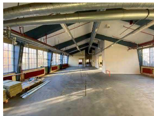
Foto 6: Diverse udsug i loft i bygning 10. Foto set fra vest mod øst.
