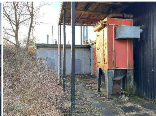
Foto 5: Udsug/filter ved den nordlige gavl (forventeligt fra slyngrenser).
