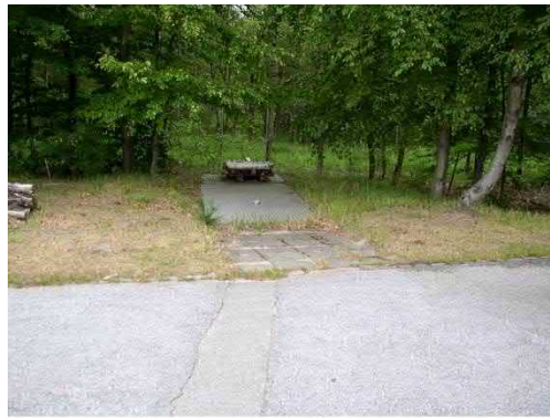
Foto 1: Dæksler for 4.000 l tank i betonkar.
