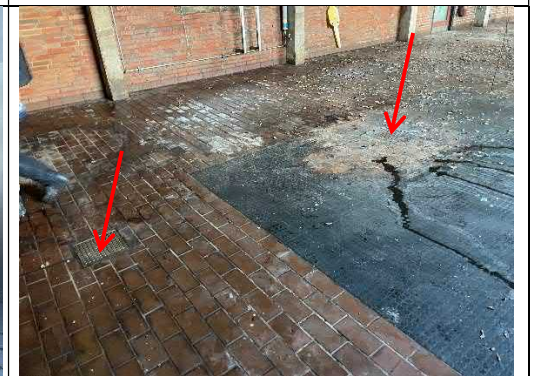
Foto 5: Der ses flere gulv afløb i det store værkstedsrum (markeret med røde pile).
