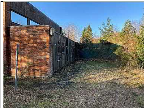
Foto 4: Bygningens nordlige facade, hvor boksene anvendt til udboring/adskillelse af granater ses.
