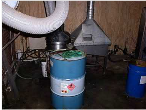
Foto 3: Oliecentrifugerum til olie- og fedtudskilning for spildevand inden det ledes til forrenseanlæg.
