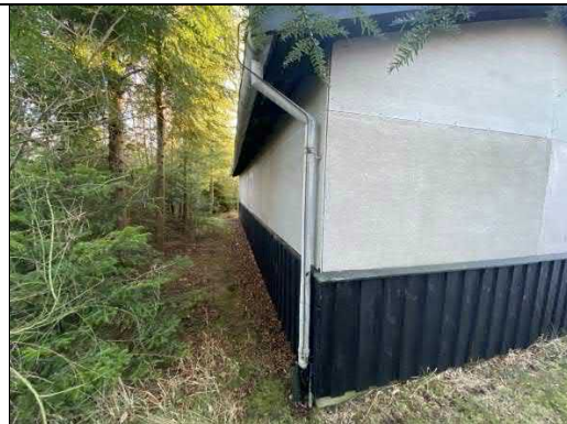
Foto 3: Kemikalieoplag/syreskur nordlige facade.
