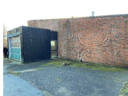
Foto 3: Den nordlige facade af bygning 7, hvor 1.500 l opsamlingsstank er nedgravet.
