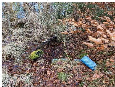
Foto 6: Udledning af drænvand/tagvand til vådområde nord for bygning 7.
