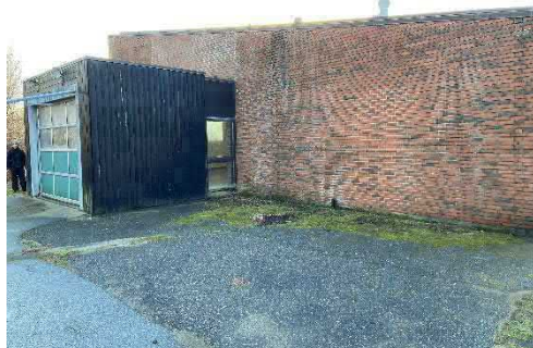
Foto 3: Den nordlige facade af bygning 7, hvor 1.500 l opsamlingsstank er nedgravet.
